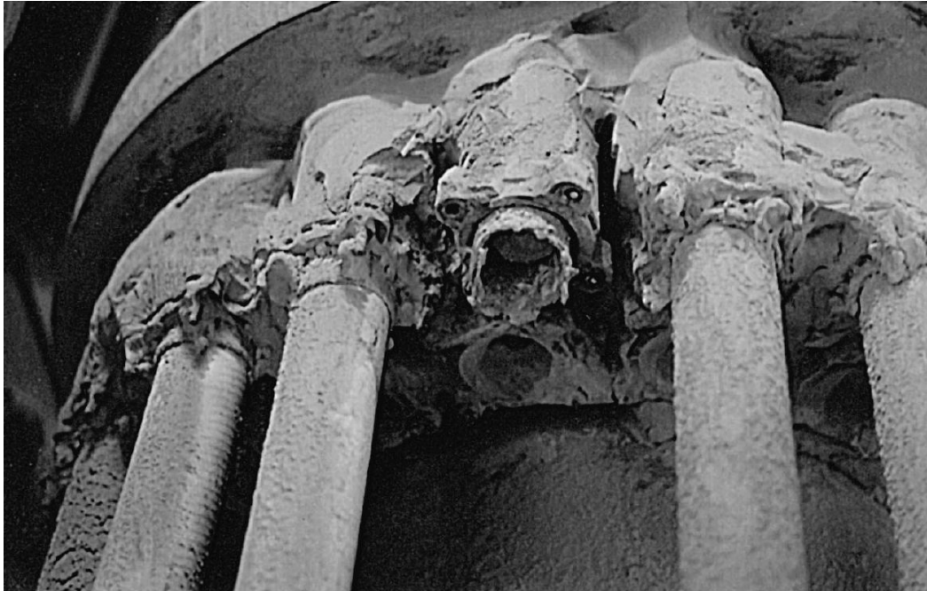
[그림 36] 세라믹 캔들 필터의 열피로로 인한 파손 현상
